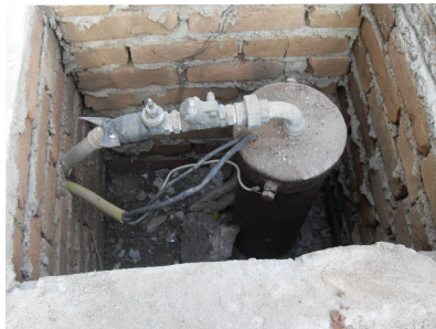
Bomba Elétrica Poço Artesiano Fundamar
